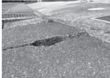
劣化による段差
