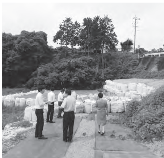
町道江北～大町線 畑川水路災害現場
