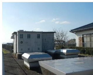
【ポンプ場施設】 名称：下分汚水中継ポンプ場 位置：江北町佐留志600番地2 竣工：平成11年3月 処理能力：3.4m 3 /分
