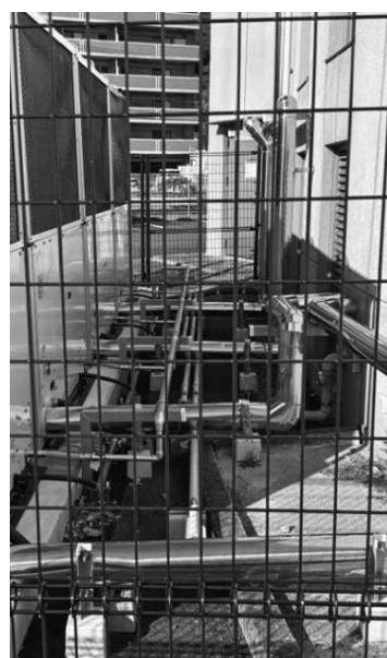
ガス配管が屋外にある施設
