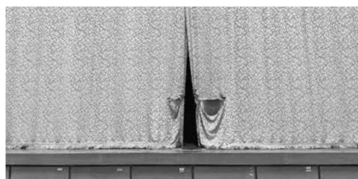
ネイブルの破損している緞帳
