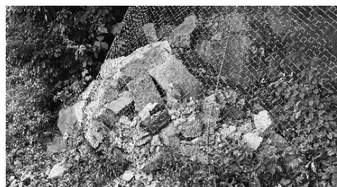
がけ崩れの箇所
