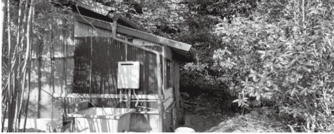
倒壊の危険がある空き家
