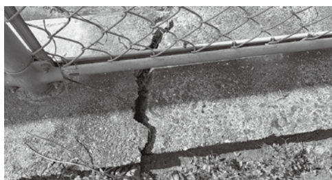
タンク周辺の地割れにも対応を
