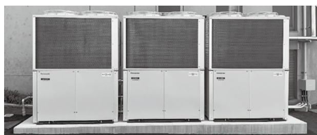
騒音問題はないことを確認 空調室外機
