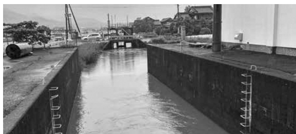
柵設置等、早急な安全対策を
