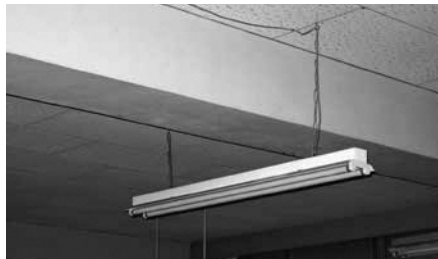
教室中央に、増設された蛍光灯
