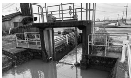
改修が必要 上小田二本松制水門
