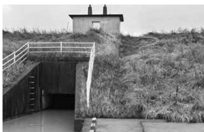
階段もなく、危険な長江湖樋管
