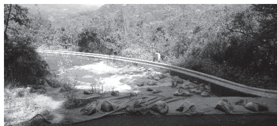
ブルーシートで覆われた地滑り箇所
