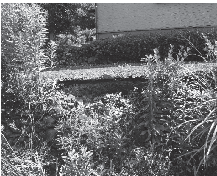
白木地区の崩れかかった道
