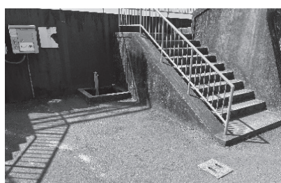
排水管の砂詰まり
