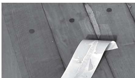
損傷の激しい床
