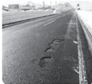
路面の穴ぼこ・ 段差
