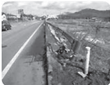
ガードレール・ 標識等の損傷
