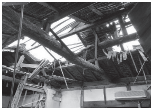
危険な空き家
