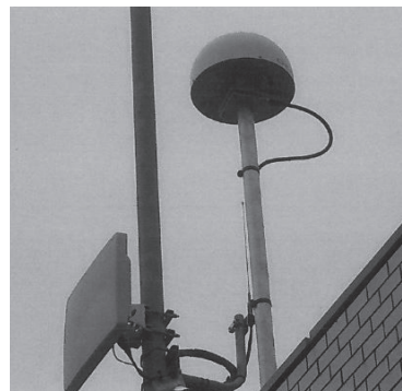
屋上に整備された基地局
