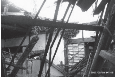
倒壊が進む、3月後の同空家
