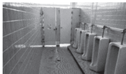
臭いが解消されたトイレ
