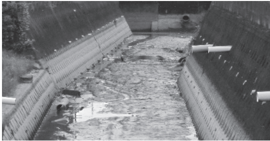
浸水被害の一因となる泥土
