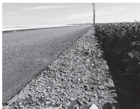
町道のり面被害の状況
