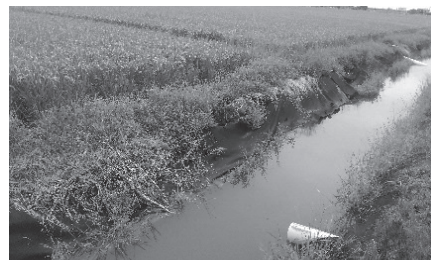
下惣 崩落した水路
