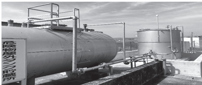
東古川排水機場に新たに設置された燃料タンク
