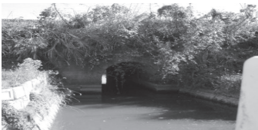
排水が追い付かない大西鉄道橋付近
