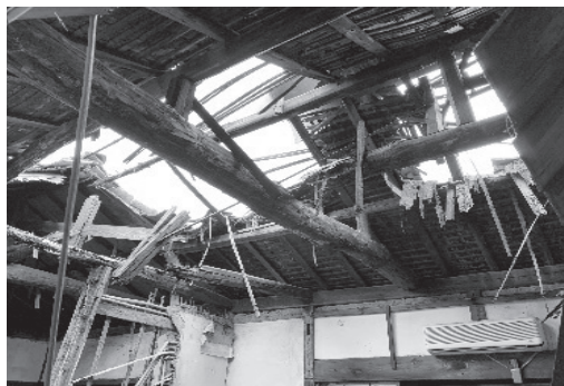
新町区の空き屋 天井に穴
