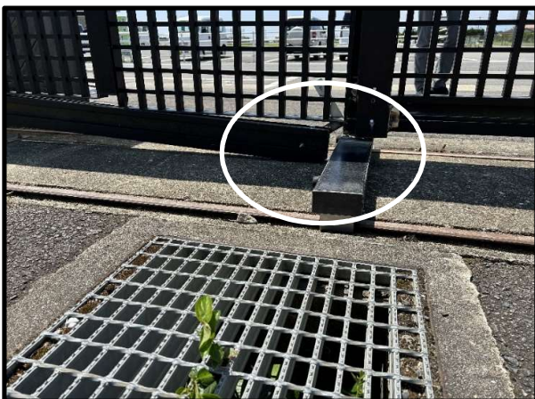
枠が外れ、支障となり、開閉が困難な状況。
