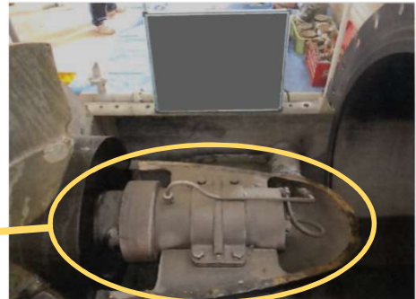
劣化した部品
