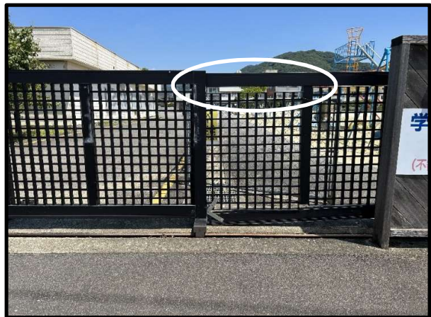
枠が外れたことにより、格子が落下している。
