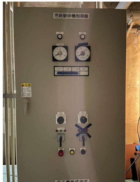
(し渣破砕機用制御盤)
