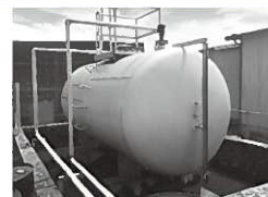
排水機場の燃料タンク
