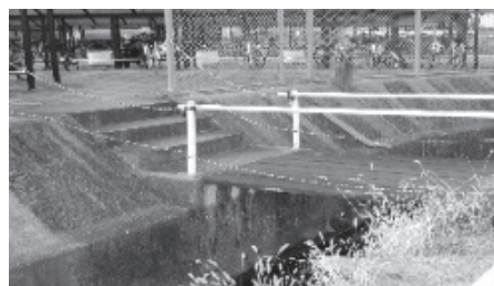
階段通路に手すりが必要
