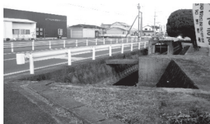
ガードレールや柵がない水路
