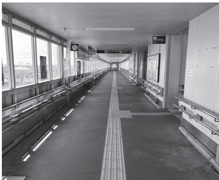
経年劣化のため改修されるふれあい通路
