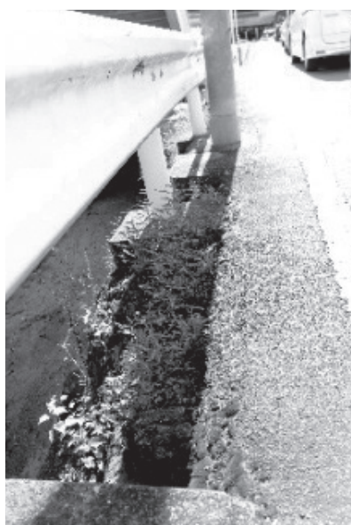
崩れが心配な土台
