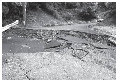
道路被害状況（花祭地区）
