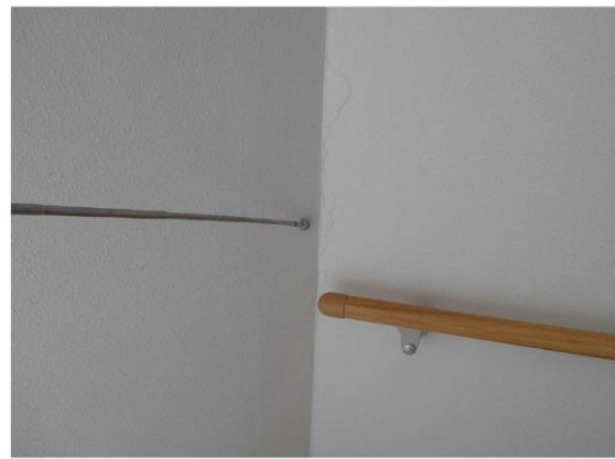
③-2 躯体のひび割れ
