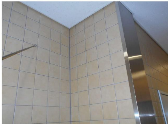
③-6 内装タイル貼り（便所）が各所にあり
