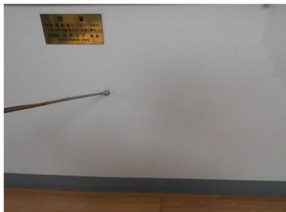
③-2 躯体のひび割れ
