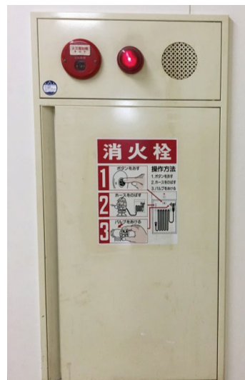
しつないよう せん ひじょう 室内用消火栓と非常ベル
