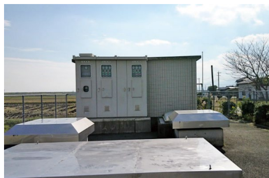
下分中継ポンプ場
