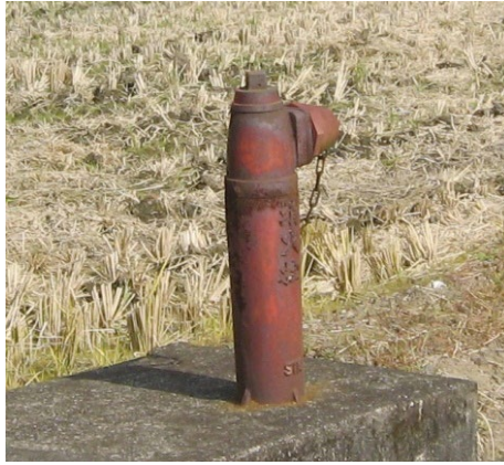
ちじょうしき せん 地上式消火栓
