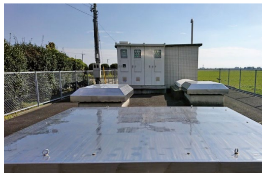
祖子分中継ポンプ場
