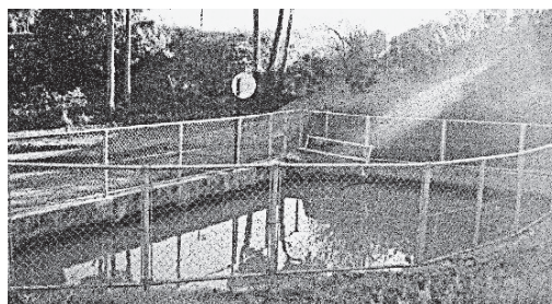
汚泥が堆積している岳地区の防火水槽
