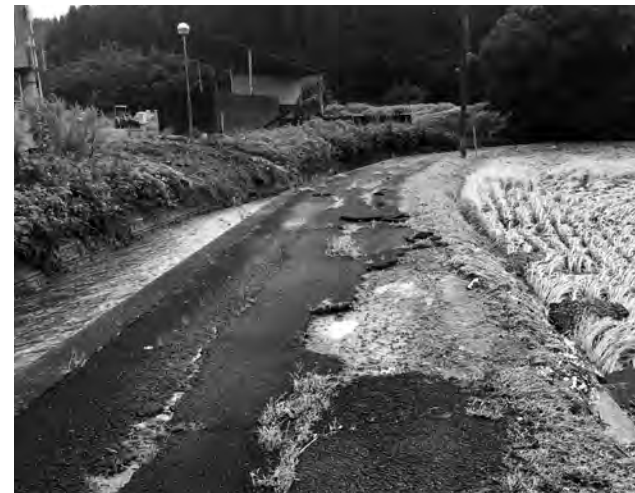
路面の剥離。地盤が露出しており、流出しやすい状態となっている。
