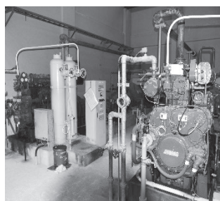
(朽木ポンプ場エンジン)
