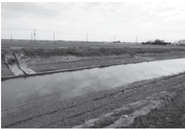
崩れた張りブロック・U字溝
