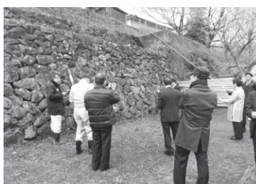
膨らんでいるブロック積状況
