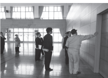
ネイブル内の劣化した壁
