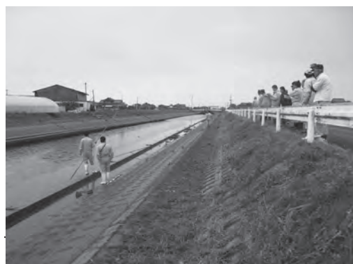
幹線水路泥土堆積状況立会
