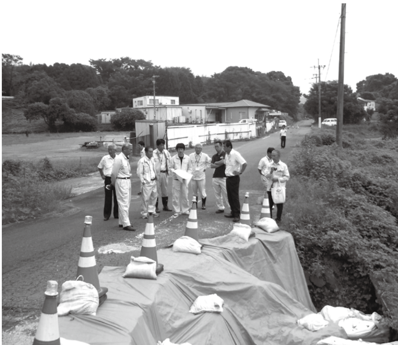
平成29年7月6日の豪雨により崩落した観音下区の現場 復旧の見通しは、調査後、来年になる。
