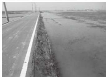
崩れかけている側面
